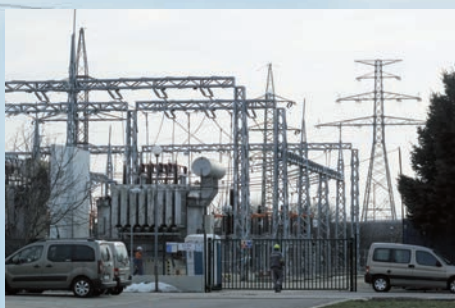
Konečná drôtov v Petržalke: rozvodňa na Kolmej ul.
