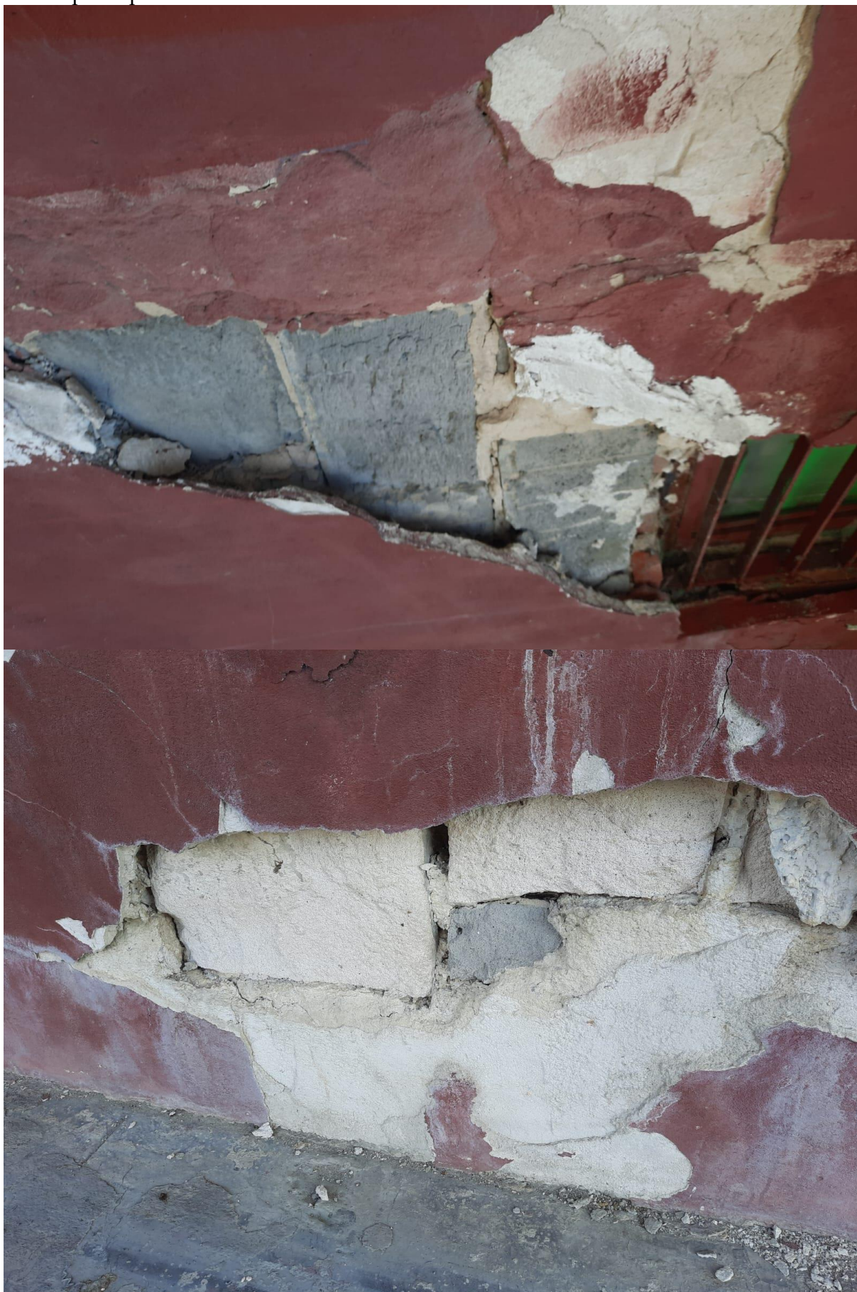
Fasáda pred opravou:
