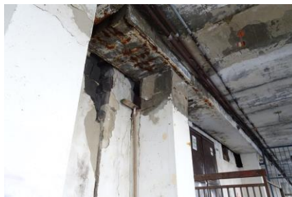
Havarijný technický stav konštrukcie
