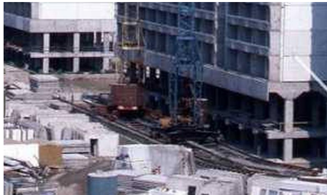
Petržalka : prefabrikovaný žb skelet parteru + ľahká demontáž = potenciál na rekonštrukciu, (fotografia vľavo : zdroj ČSTK / TASR, autor : Š. Petráš)
