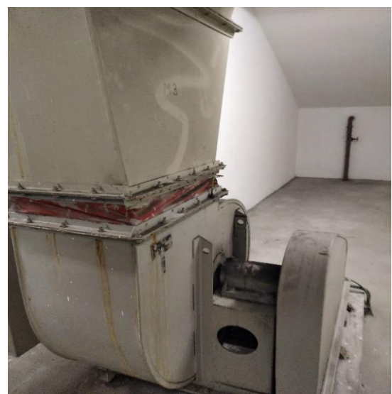
Vzduchotechnika pôvodný stav
