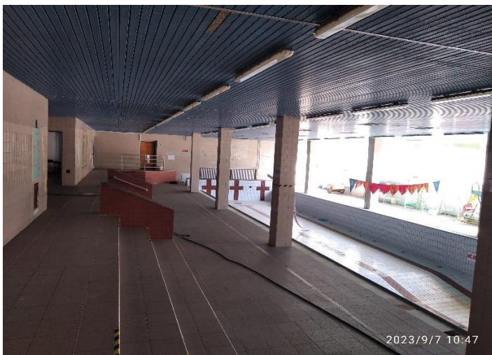
Bazénová hala, nefunkčný bazén
