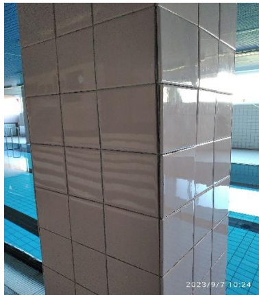
Statické poruchy na stĺpoch
