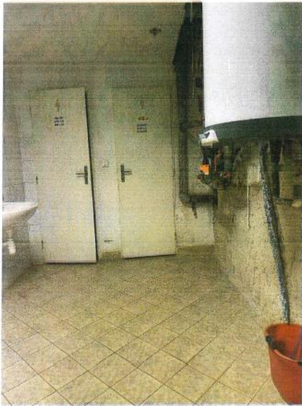
Poškodená stena z rozvodov školy
