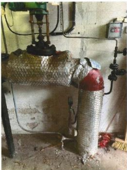
Vstup horúcej vody
