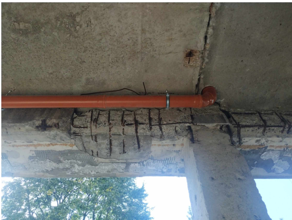
F16 Detail poškodenia konzolovej časti žb. priečie fasádneho rámu žb. nosného skeletu v modulovej rade "A" pri stípe v osi "6"
