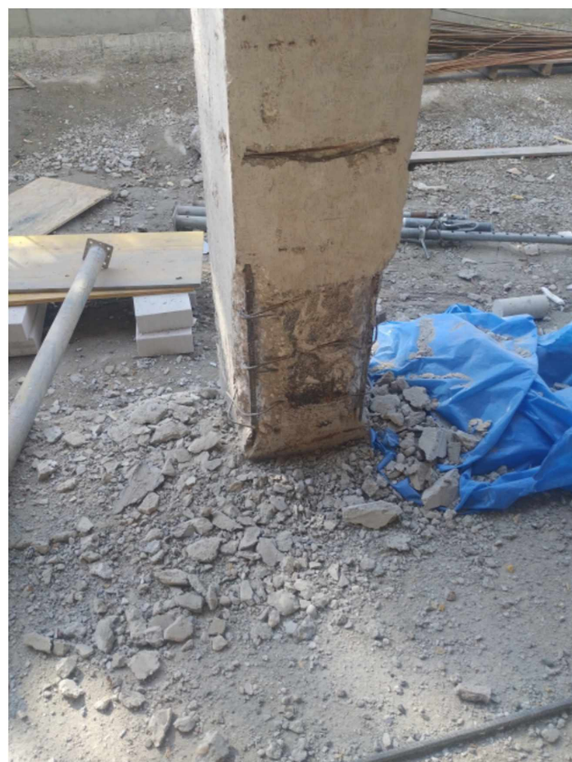
F8 Detail poruchy spodnej časti stĺpa žb. nosného skeletu v modulovej rade "B"
