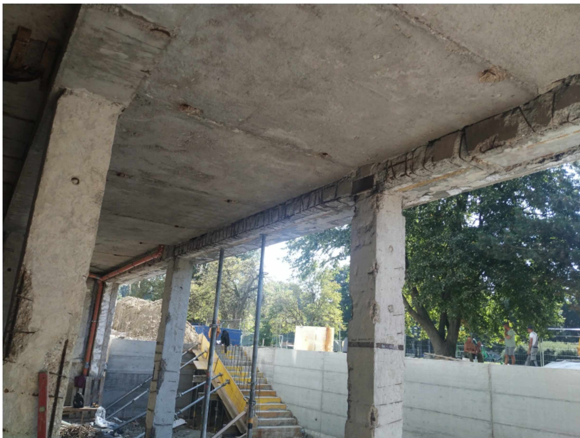
F13 Pohľad na obnažené poškodené priečle fasádneho rámu žb. nosného skeletu v modulovej rade "A"
