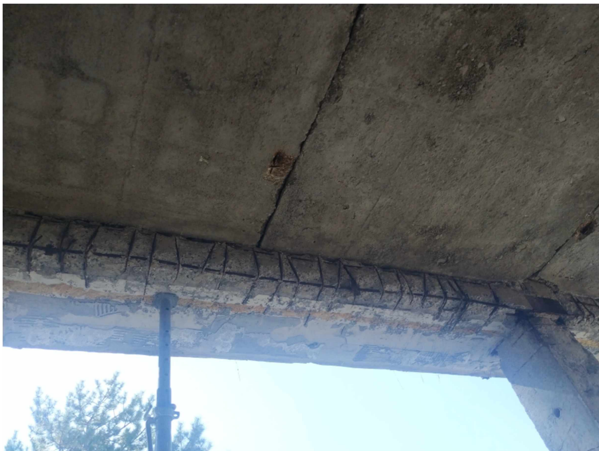
F14 Detail poškodenia žb. priečle fasádneho rámu žb. nosného skeletu v modulovej rade "A" pri stĺpe v osi "5"
