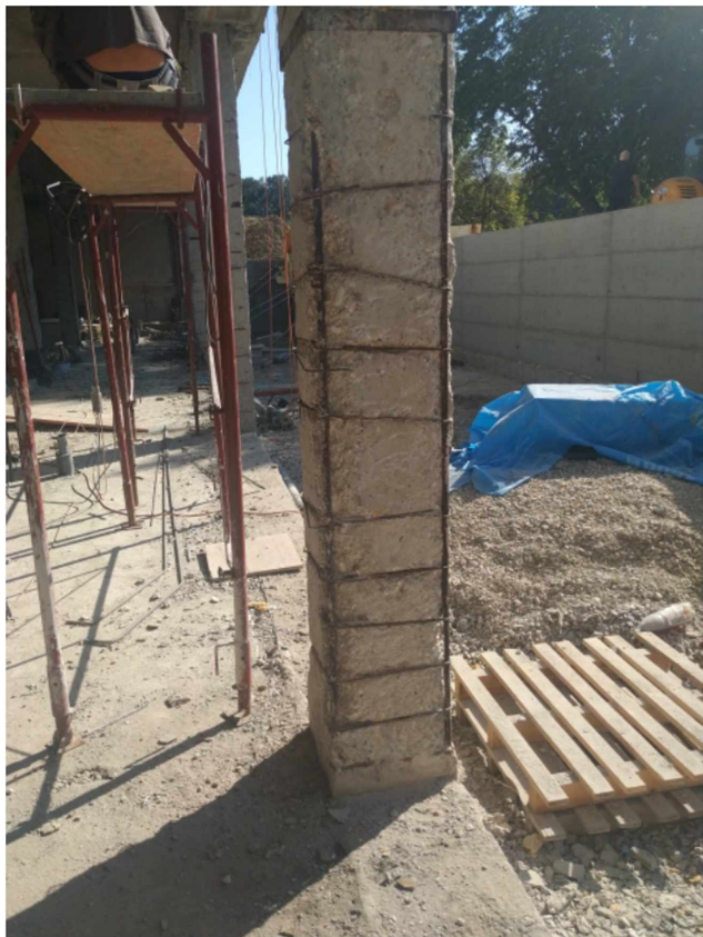
F9 Detail poruchy spodnej časti stĺpa žb. nosného skeletu v modulovej rade "A"
