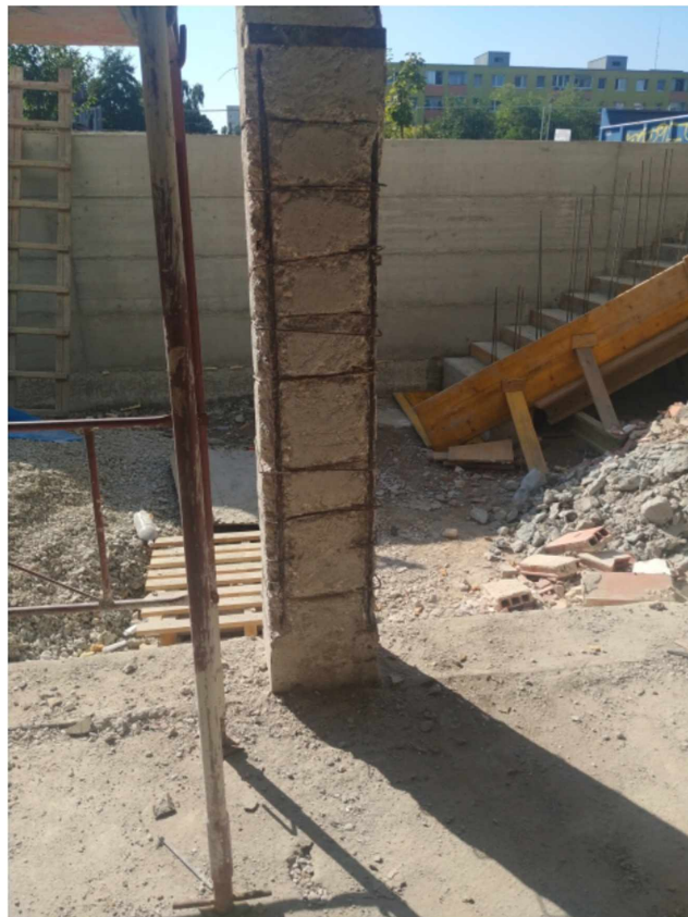
F10 Detail poruchy spodnej časti stĺpa žb. nosného skeletu v modulovej rade "A"
