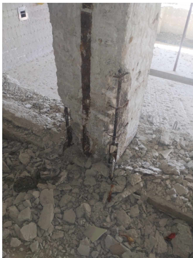
F4 Detail poškodenia stĺpa žb. skeletu v modulovej rade "C" pri jeho spodnom kotvení
