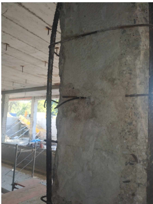
F3 Detail poškodenia hornej časti stĺpa žb. nosného skeletu v modulovej rade "C"
