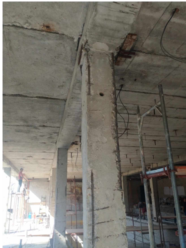
F6 Pohľad na obnažené stĺpy žb. nosného skeletu v modulovej rade "B"
