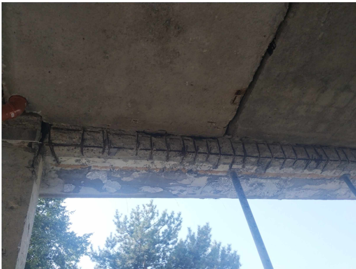
F15 Detail poškodenia žb. priečie fasádneho rámu žb. nosného skeletu v modulovej rade "A" pri stípe v osi "6"
