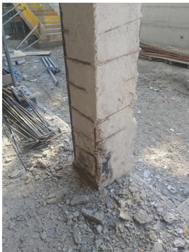
F12 Detail poruchy spodnej časti stĺpa žb. nosného skeletu v modulovej rade "A"
