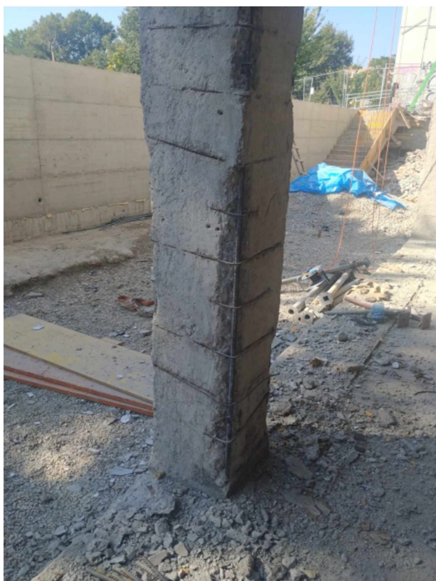
F11 Detail poruchy spodnej časti stĺpa žb. nosného skeletu v modulovej rade "A"
