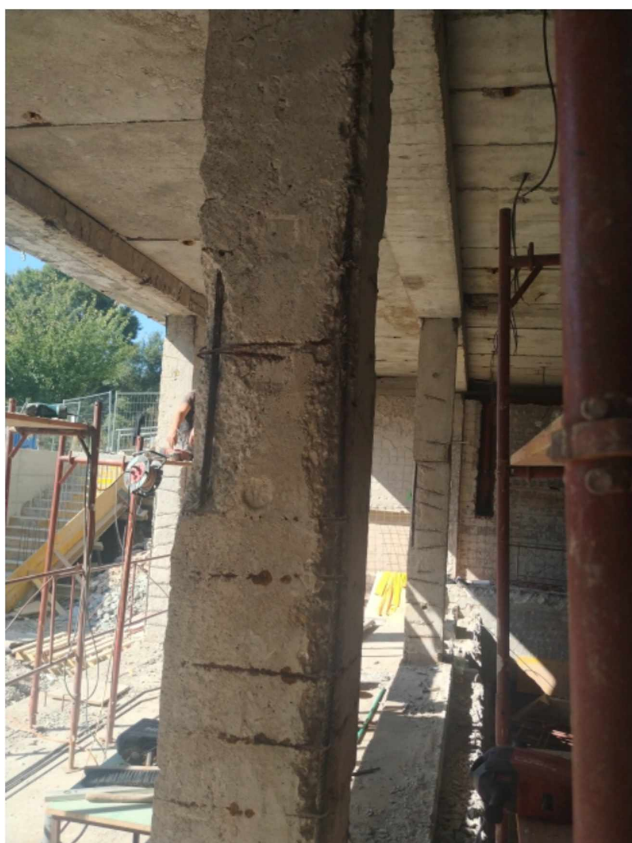
F7 Pohľad na obnažené stĺpy žb. nosného skeletu v modulovej rade "B"
