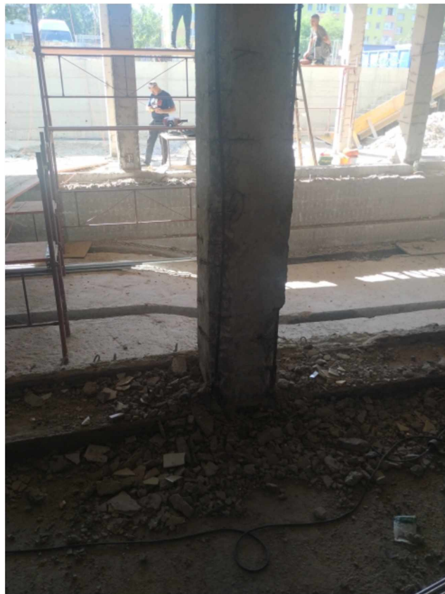
F2 Detail poškodenia spodnej časti stĺpa žb. nosného skeletu v modulovej rade "C"
