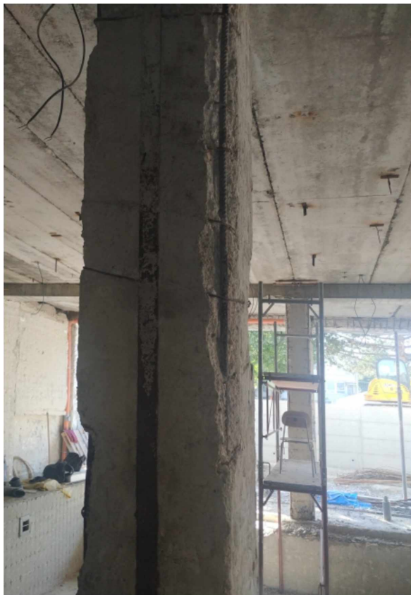
F5 Detail poškodenia hornej časti stĺpa žb. nosného skeletu v modulovej rade "C"
