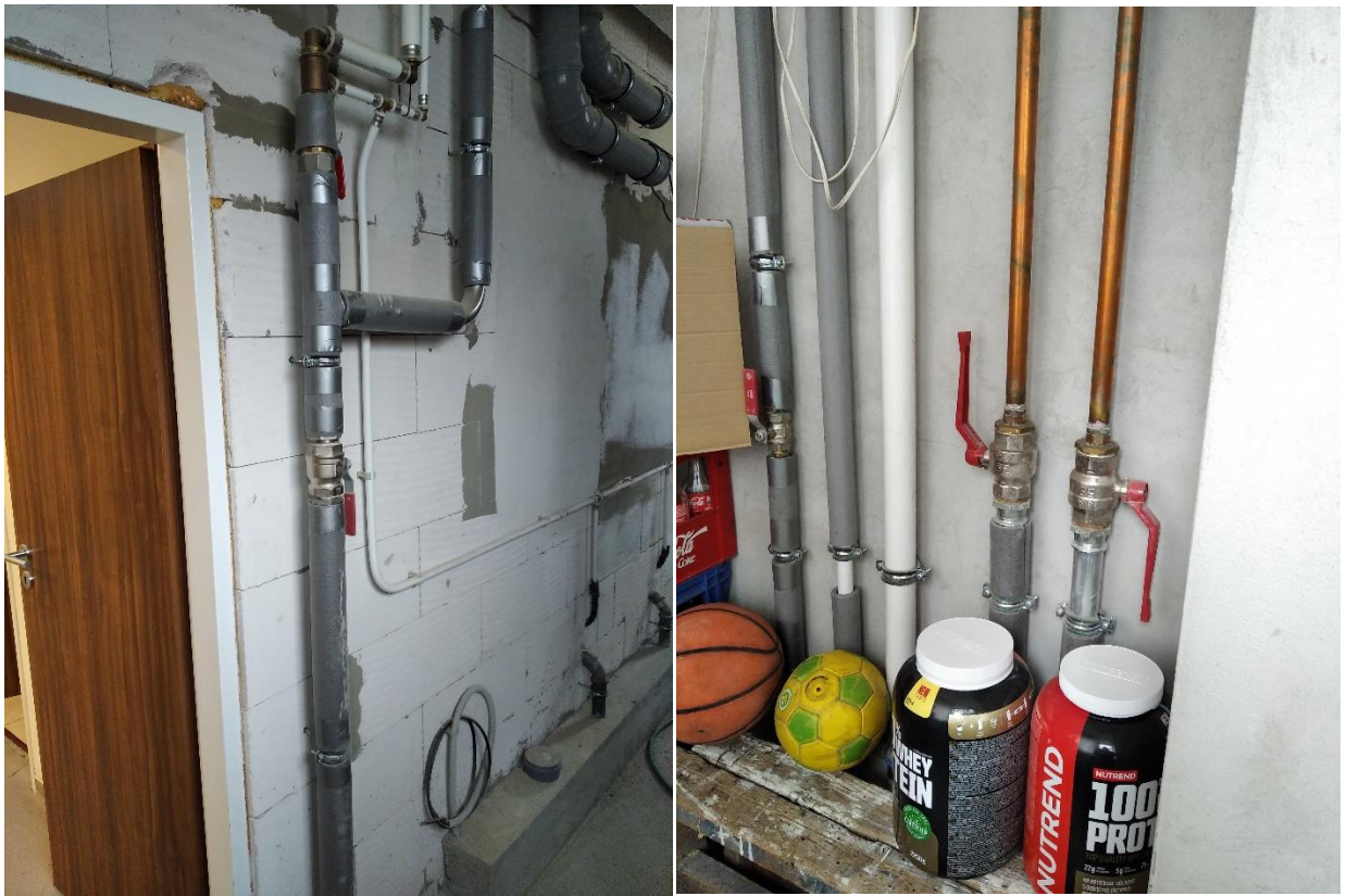
Termostatické hlavice, část nových rozvodů ÚK a TUV
