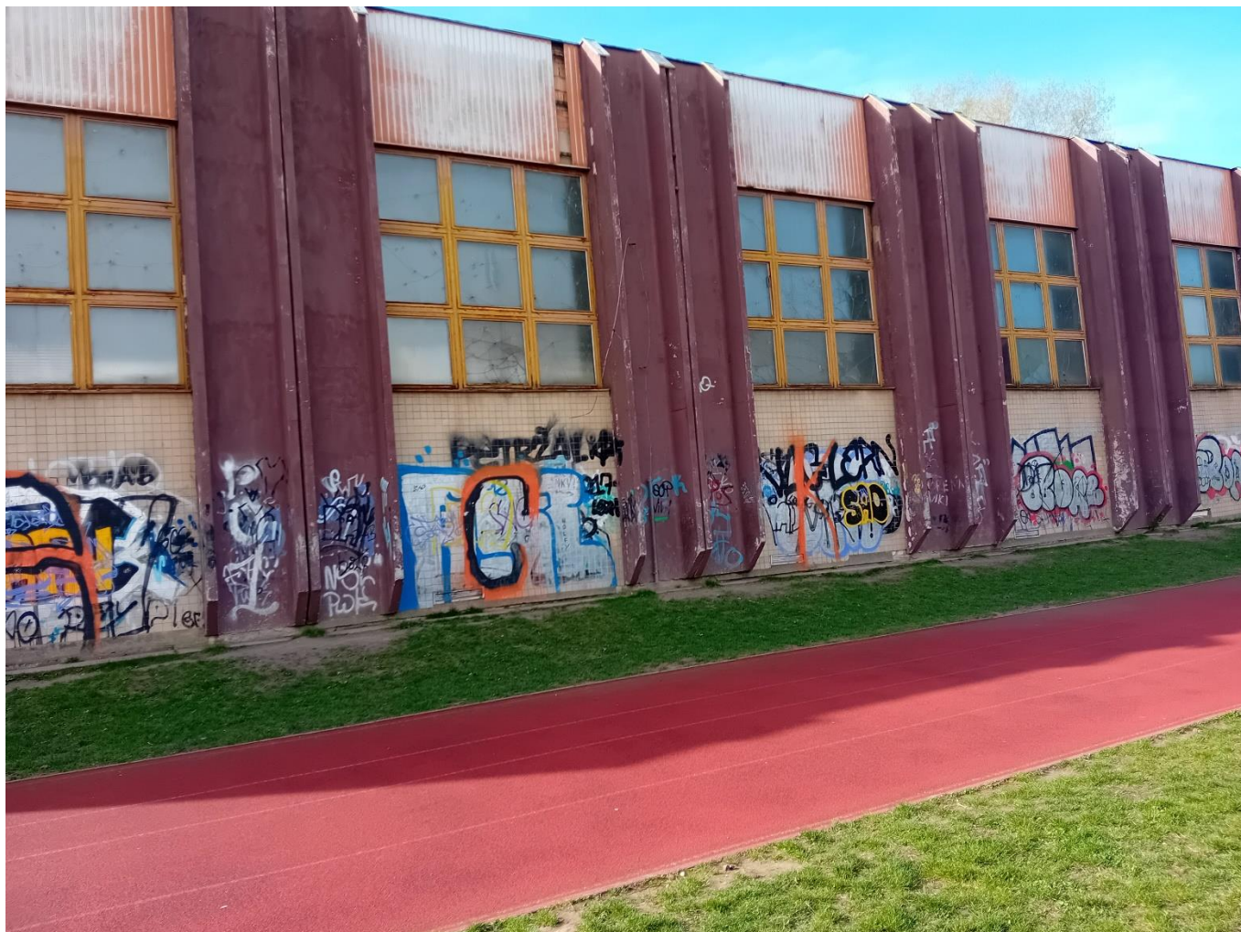
Severná strana budovy – pôvodné okná a nevyhovujúci stav bleskozvodov
